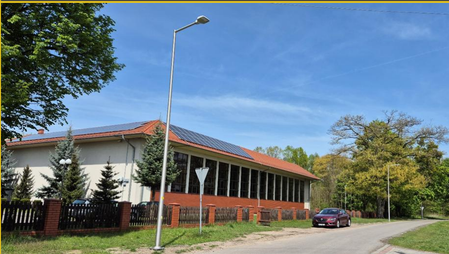
Instalacja PV na dachu hali sportowej
