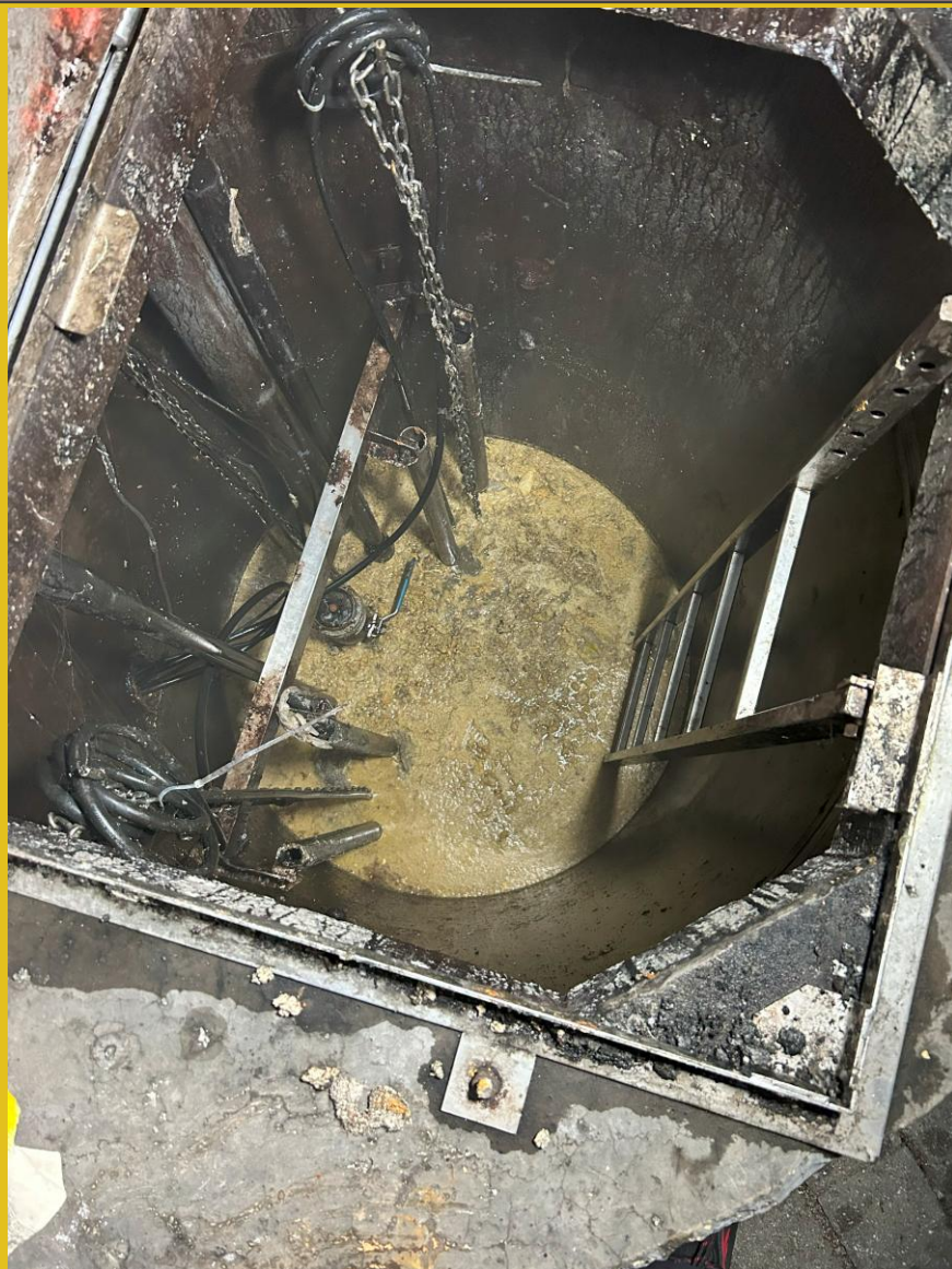
Zanieczyszczenia w przepompowniach
