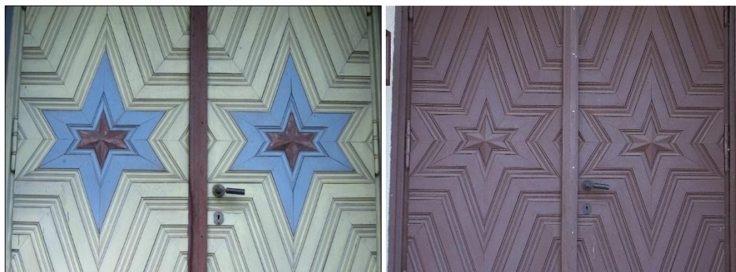
Detal głównych drzwi świątyni w 2010 ... oraz w 2020 r.
